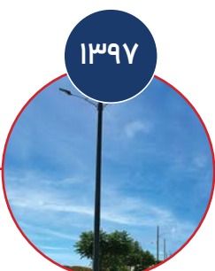
پایه روشنایی Lighting Pole
